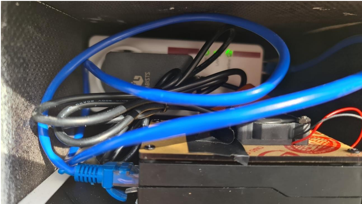
Abbildung 4 Hier die Konstruktion auf der eingebauten Einschubleiste aus der Nähe. Der raspi 4 hat einen Ventilator. Der ist notwendig, denn es kann ganz schön warm werden.
