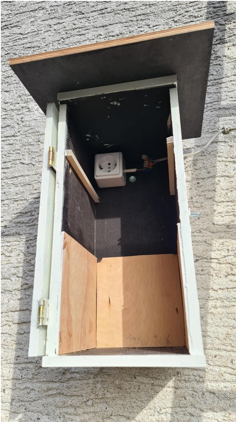
Abbildung 1 Der Kasten ist aufgehängt und fertig zur Installation der technischen Komponenten. Ein angeschrägtes Dach hat er auch noch verpasst bekommen. Man beachte die Seitenleisten für den Einschub. 35 cm Höhe bis zum Boden ist ok.
